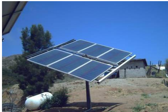
Figura 5. Panel Fotovoltaico en zona rural
