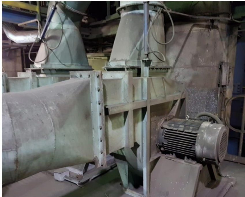
Ilustración 15: Ventilador aire de sello
