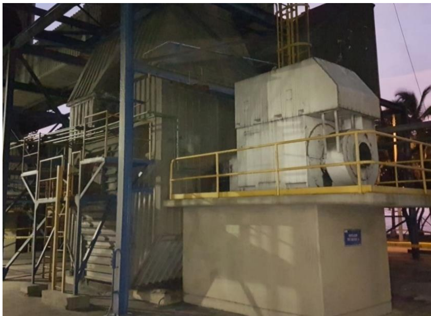
Ilustración 16: Ventilador de tiro inducido
