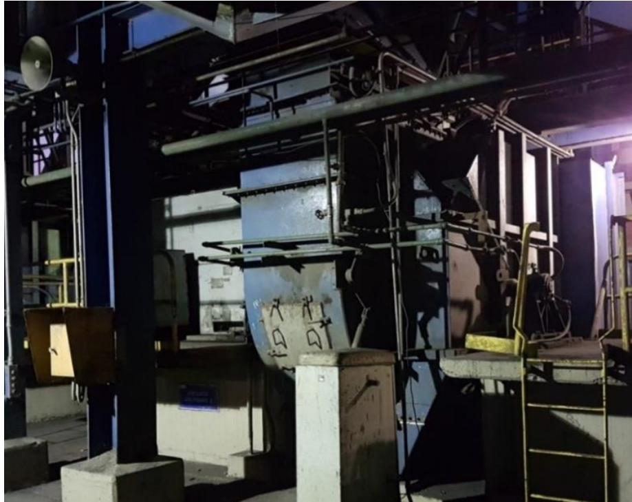
Ilustración 14: Ventilador de aire primario
