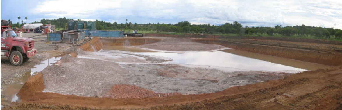
FOTOGRAFÍA 16: PISCINA DE DISPOSICIÓN DE CORTES BASE AGUA Fuente: Autores
