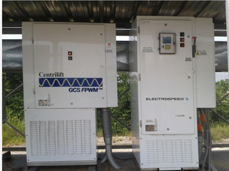
Figura 5 Variador de Frecuencia de una Bomba Electro -Sumergible
