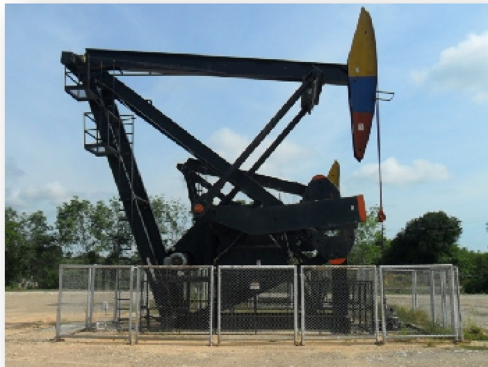
Figura 3 Unidad de Bombeo mecánico tipo Mark II
