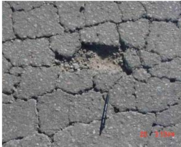
Figura 6. Agrietamiento estructural por fatiga y envejecimiento
