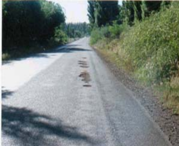
Figura 8. Deterioro de grietas anchas y pérdida de áridos severa.
