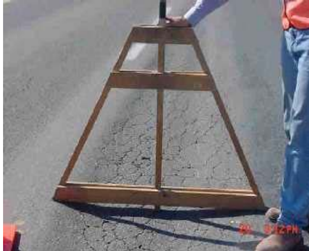
Figura 9. Deformación permanente en el pavimento.
