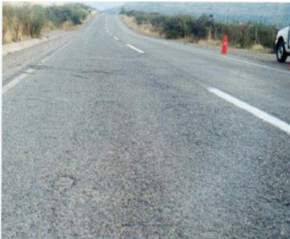
Figura 7. Pérdida progresiva de material en la superficie.
