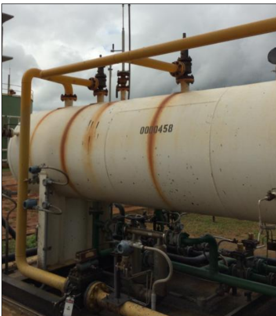
Figura 11. Separador de Prueba.
