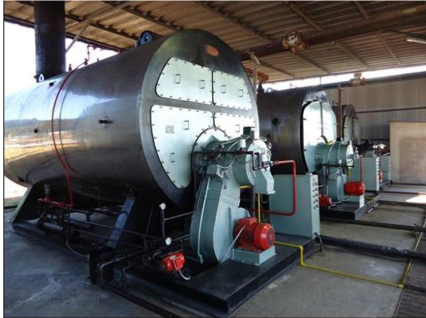
Figura 14. Calderas Piro-tubulares de la Estación Caracara Sur.
