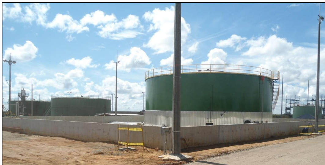
Figura 10. Tanques de Almacenamiento.
