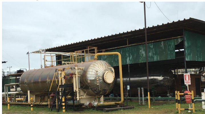
Figura 6. Intercambiadores HE-2101 A/B.
