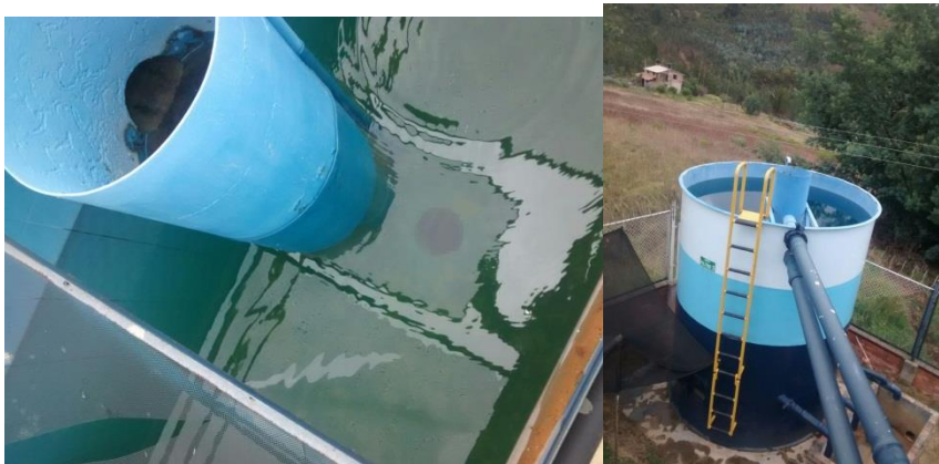
Figura 8. Estructura de Filtros
