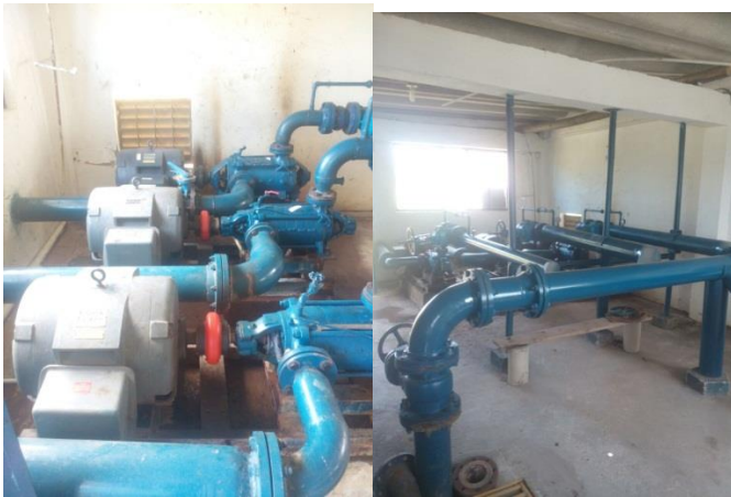
Figura 4. Estación de bombeo
