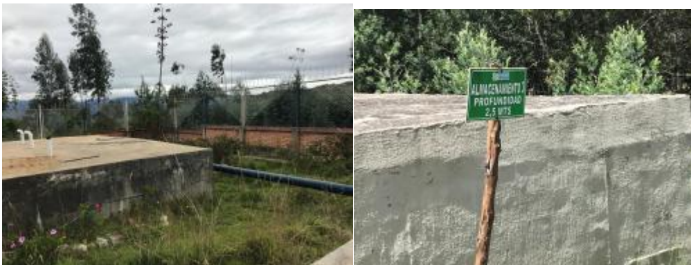
Figura 10. Estructuras tanques de almacenamiento
