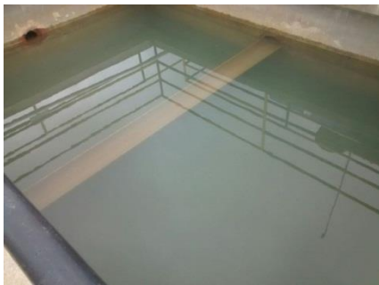
Figura 7. Estructura del sedimentador.
