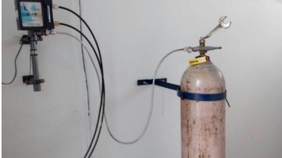
Figura 9. Sistema de desinfección
