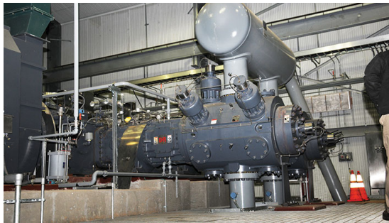
Figura 1. Compresor reciprocante en una planta de proceso
