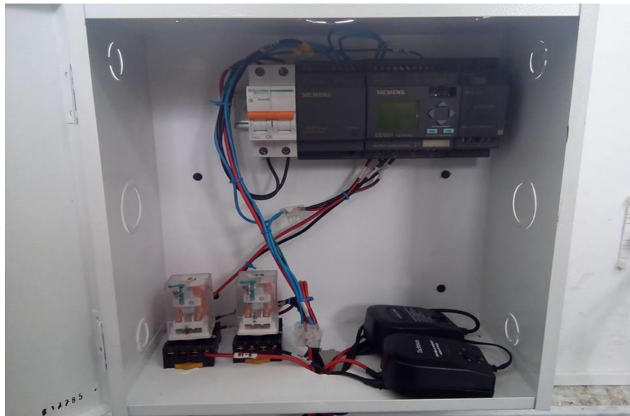
Figura 16. Caja principal donde está el PLC, las fuentes de alimentación del sensor y los relés de activación de los telones.
