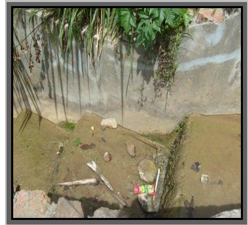
Residuos sólidos ubicados en el tramo del afluente canalizado.
