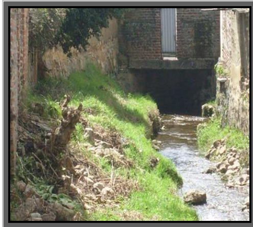
Cauce de la Quebrada la Magnolia que pasa por debajo de las edificaciones
