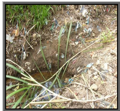
Afluente de la Quebrada en forma subterránea debido al taponamiento del cauce por la disposición indiscriminada de basuras y fenómenos erosivos.
