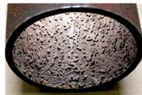
Control de la Corrosión
