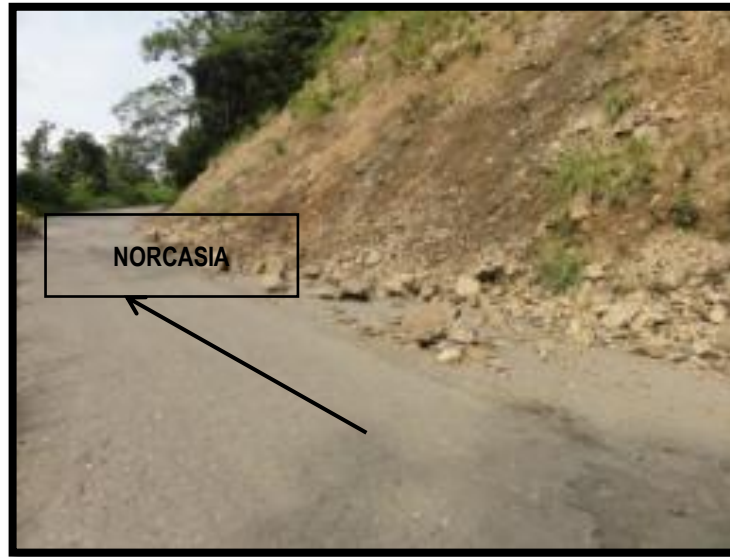
Foto 120. Afectación en la vía
