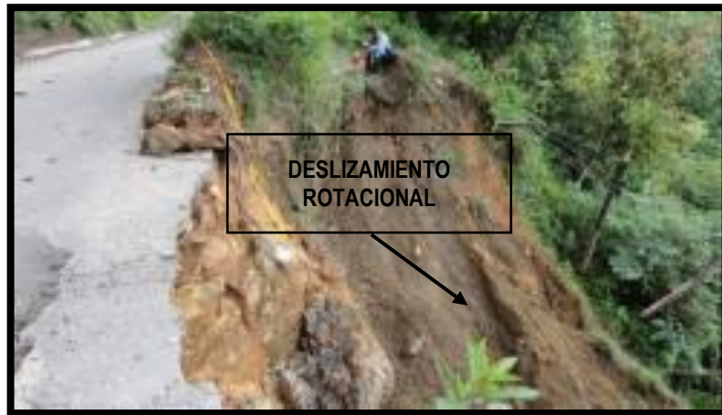
Foto 126. Daños del derrumbe
