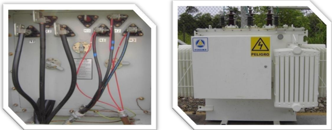
Figura 24. Taps del Panel del Transformador
