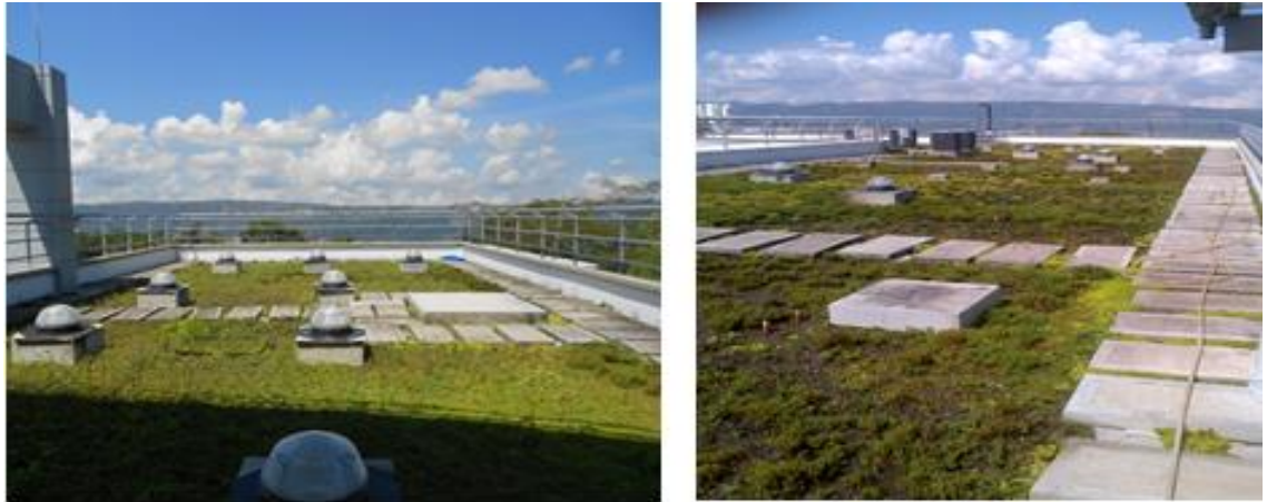
Fotografía 2. Cubierta verde del edificio E3T.
