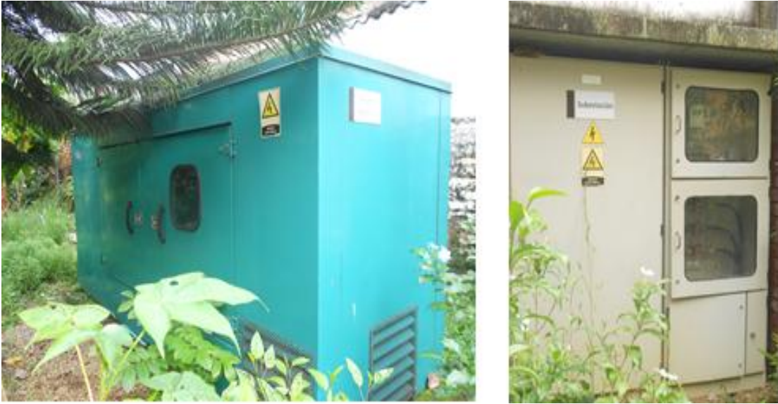
Fotografía 6. Planta eléctrica del edificio CIBIMOL CROM-MASS
