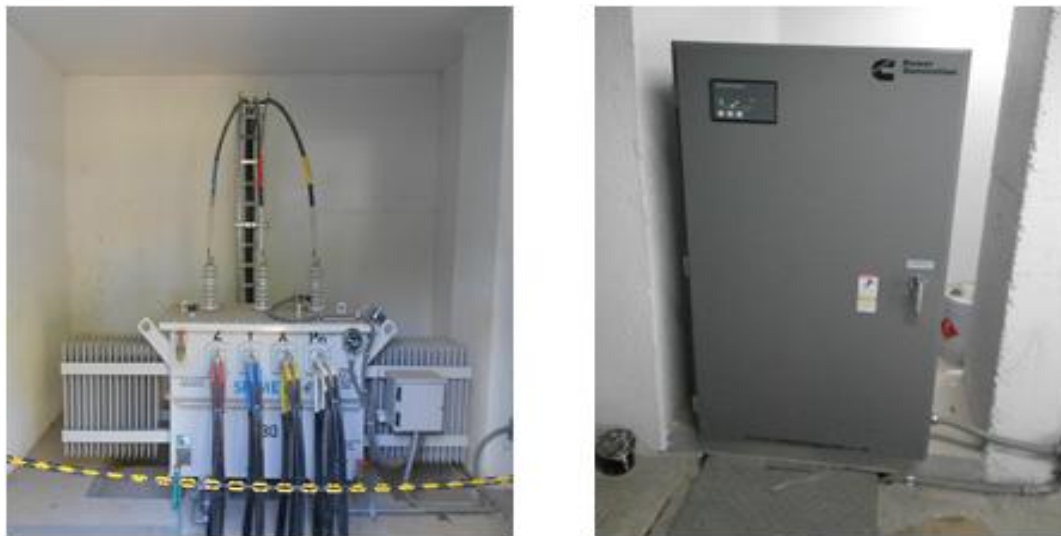
Fotografía 4. Planta eléctrica del edificio E3T.
