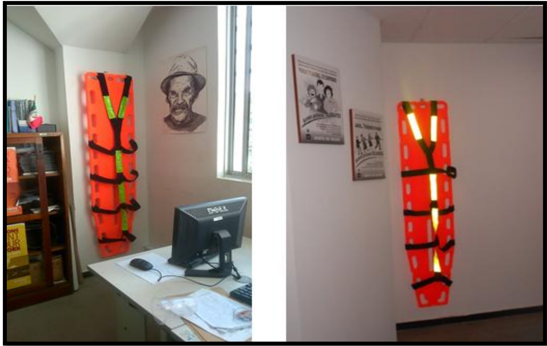
Fotografía 7. Camillas para la atención de emergencias del edificio E3T.
