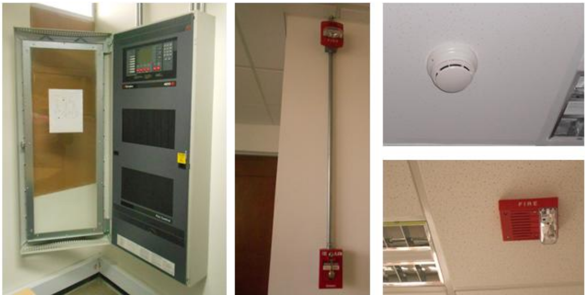
Fotografía 8. Algunos elementos que componen la alarma contraincendios del edificio E3T.
