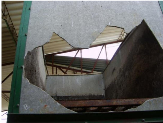
Foto 4. Paredes del bio-reactor. Fuente: autores
