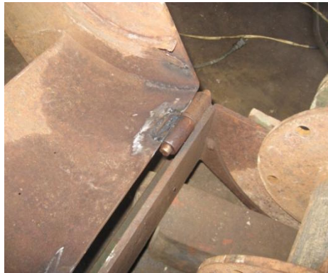
Foto 9. Detalle de reparación de soldadura de la tapa del molino de martillos.
