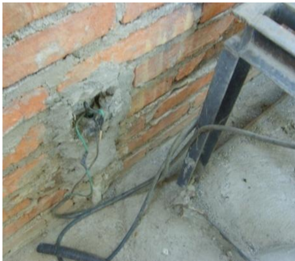
Foto 7. Conexiones eléctricas. Fuente: autores
