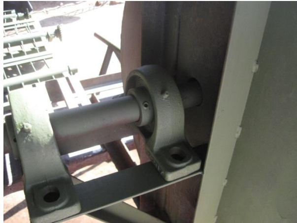
Foto 16. Ventilador de aspiración centrífugo con capa de pintura anticorrosiva.
