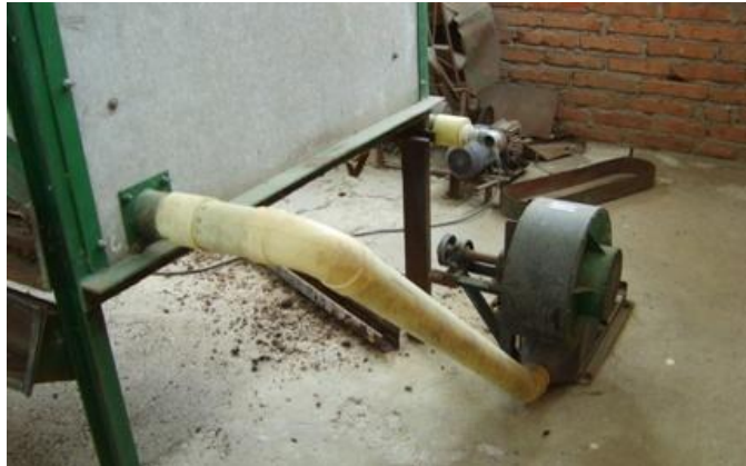
Foto 6. Sistema de inyección de aire. Fuente: autores
