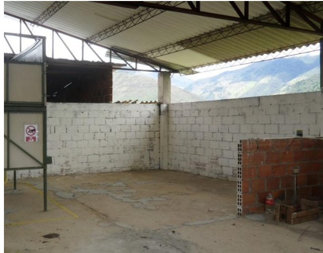
Foto 20. Recomendación de instalación de rejas para evitar el robo continuado de equipos
