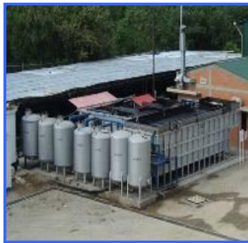
PLANTA DE TRATAMIENTO DE AGUA
