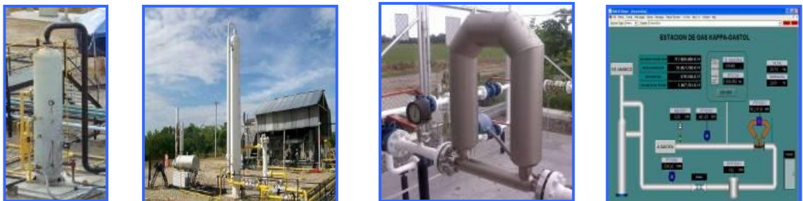
Figura 8. Tratamiento de gas
