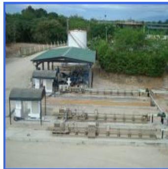
SISTEMA DE INYECCIÓN (BOMBAS MULTI ETAPAS, QUINTUPLEX Y TRIPLEX)
