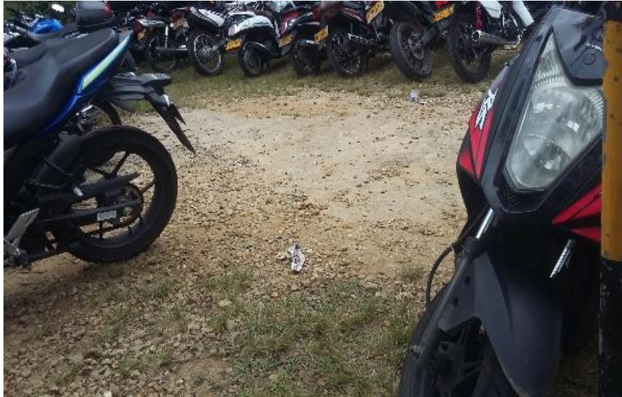
Figura 14. Estado del pavimento en el parqueadero, zona 11.
