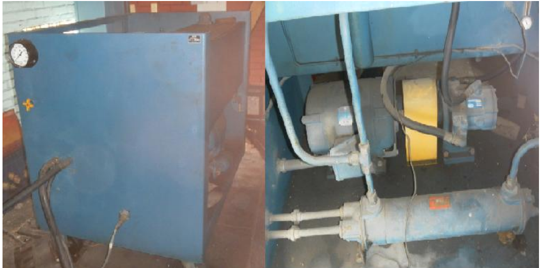
Figura 63. Modulo de potencia
