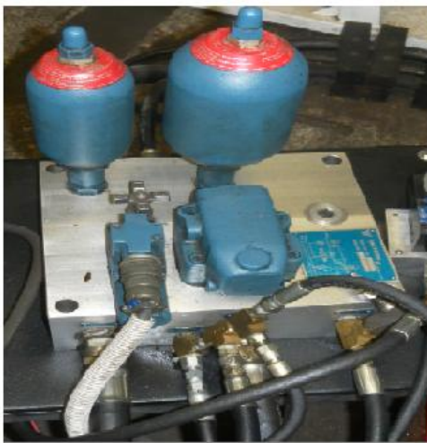
Figura 67. Manifold de control de flujo.
