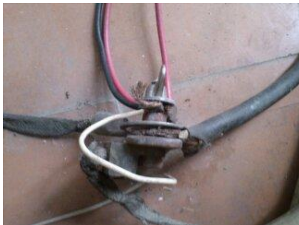
Figura 66. Conexión errónea en el LAT
