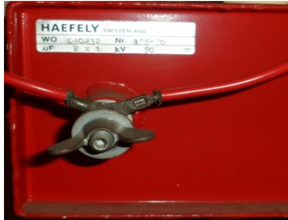
Figura 26. Terminal defectuosa GIT.
