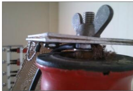
Figura 32. Bornera de conexión superior.
