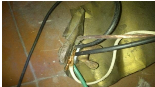
Figura 33. Punto de anclaje con varias conexiones.
