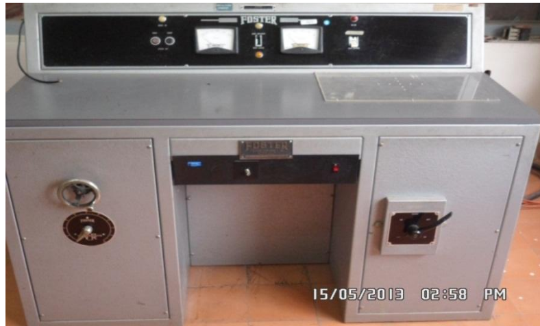
Figura 23. Consola del transformador elevador de tensión.
