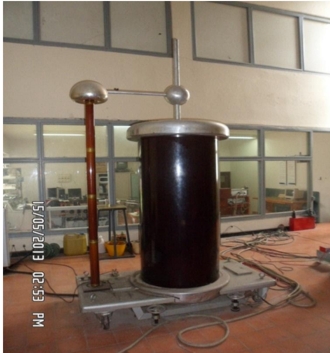
Figura 22. Transformador elevador de tensión.
