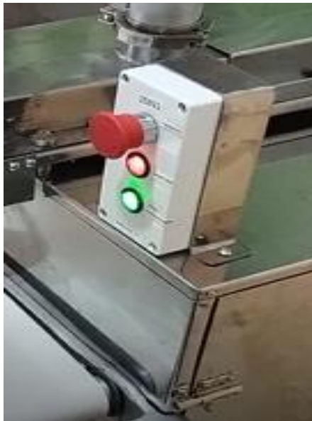
Figura 48. Evidencia de funcionamiento de la caja de control eléctrico
