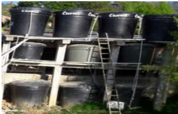
Figura 10. Tanque de almacenamiento
