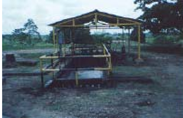
Figura 10. Separador API en Estación 2
