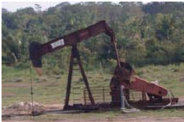
Figura 3. Unidad de Bombeo Convencional
