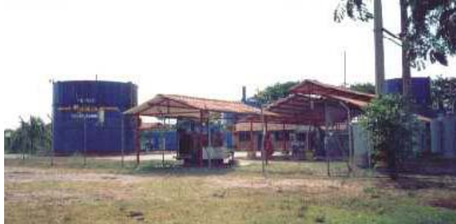
Figura 15. Planta de inyección de agua (PIA)
