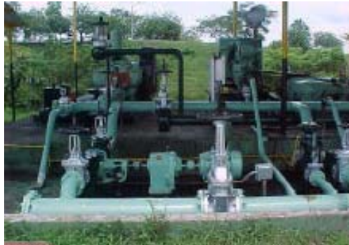
Figura 9. Área de Bombas de Transferencia a Estación Vasconia
