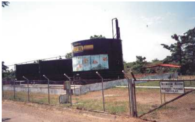
Figura 13. Zona de tanques de la Estación 4
