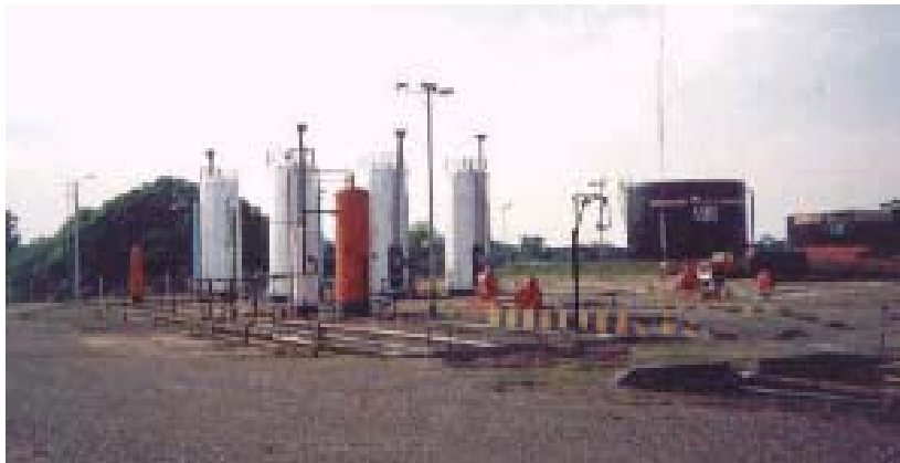
Figura 6. Área de múltiple de Recibo, separadores y Tratadores
