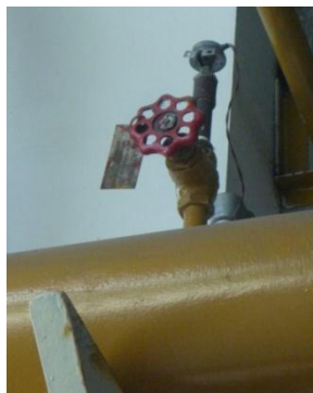
Figura 17. Transmisor de Presión a la descarga general del sistema.
