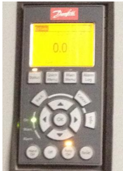
Figura 10. Variador de velocidad del compresor # 2..
