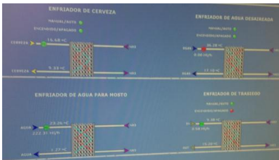
Figura 30. Interfaz INTOUCH donde se puede observar que evaporadores intermitentes están en funcionamiento.
