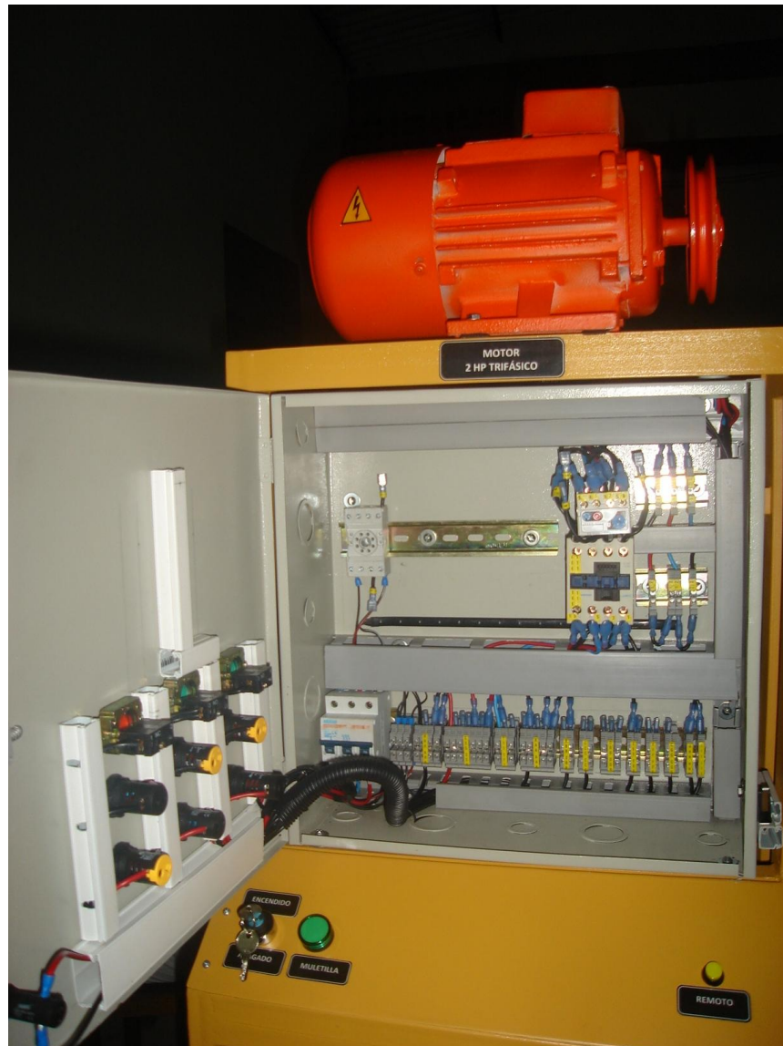
Figura 155. Arranque directo motor de 2 HP cableado
