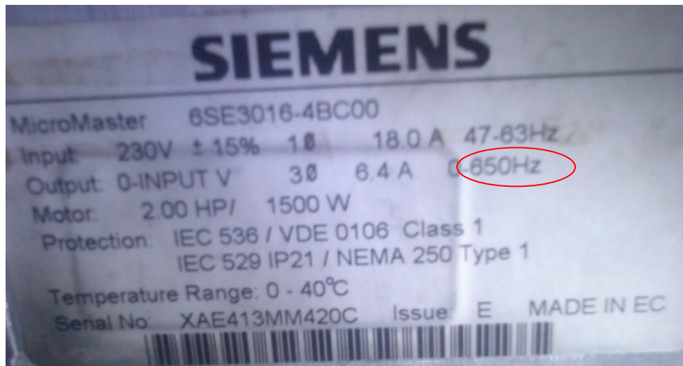
Figura 160. Placa del variador de frecuencia
