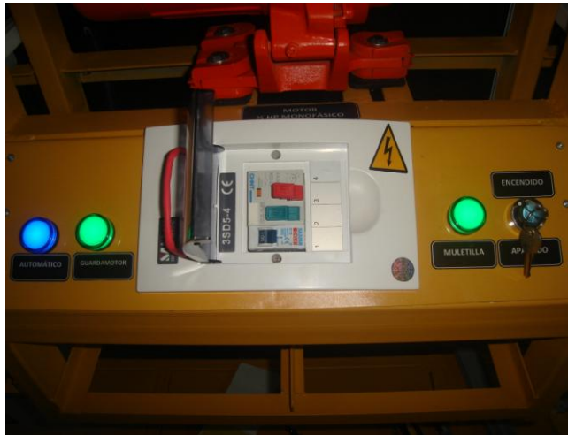
Figura 153. Detalle del panel de control en el arranque del motor de ½ HP monofásico
