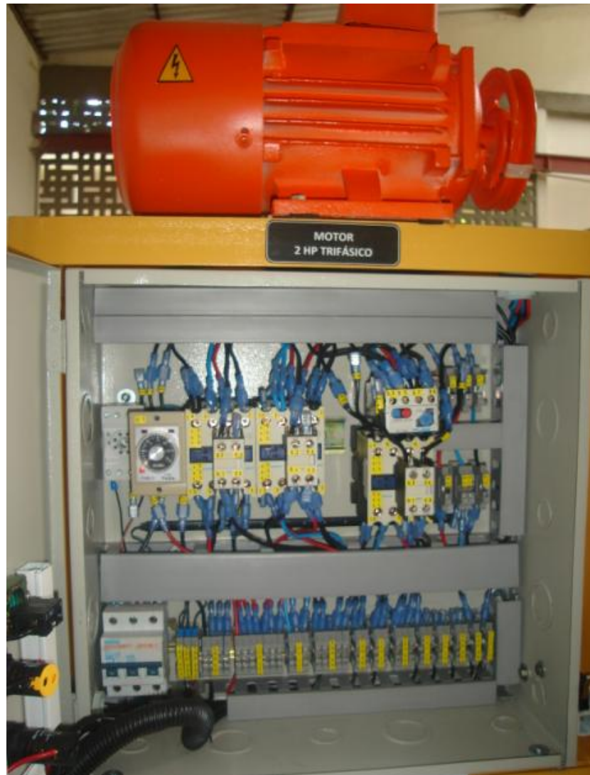
Figura 157. Arranque estrella triángulo de 2 HP cableado
