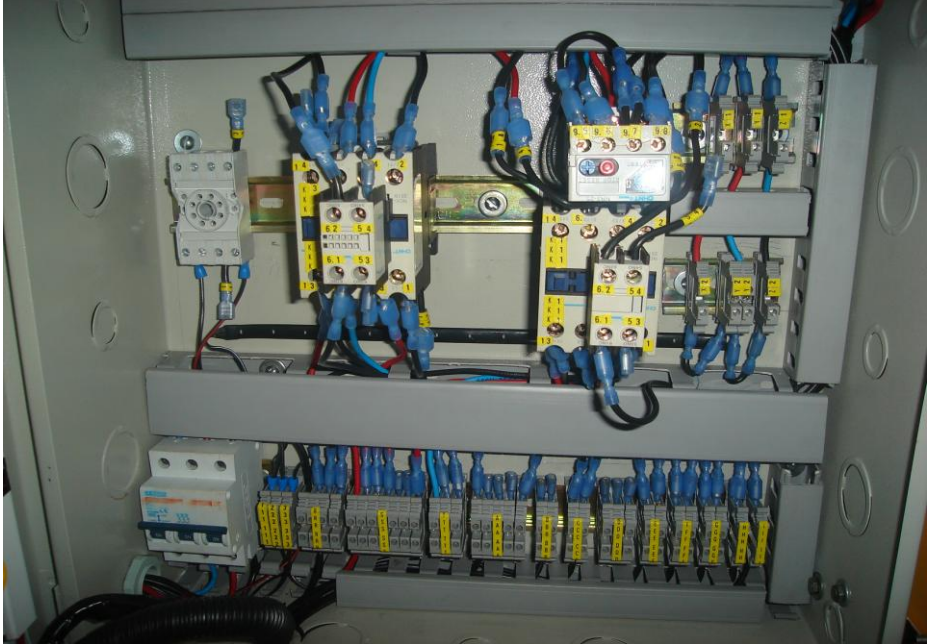
Figura 164. Circuito de inversión de giro motor trifásico 2 HP mediante método de arranque directo
