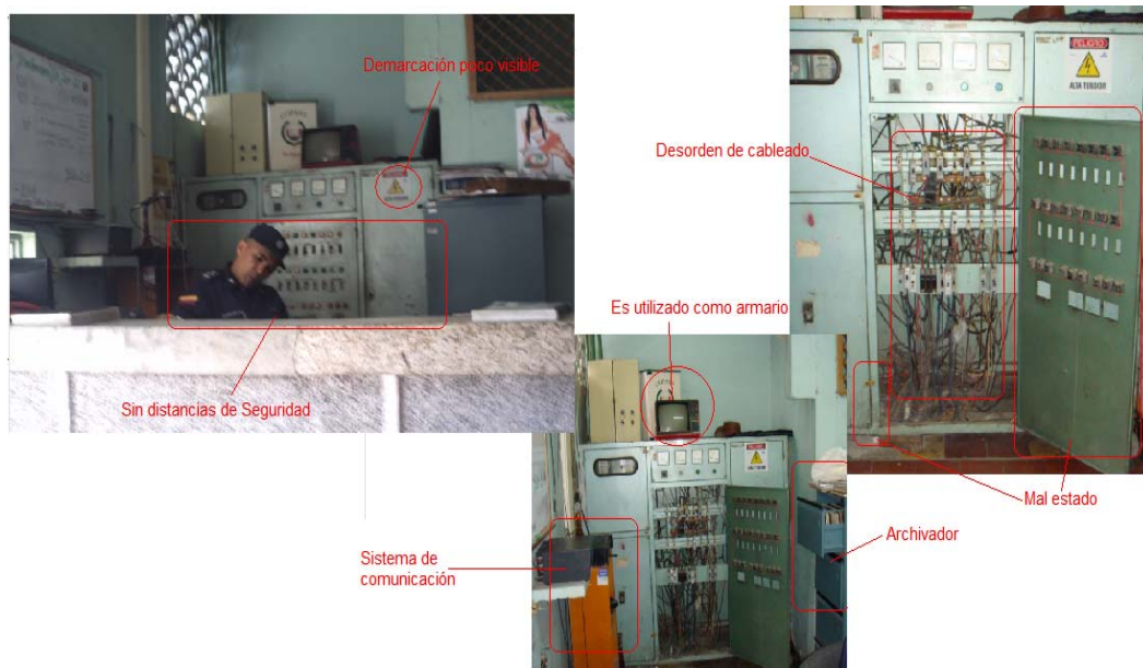
Figura Revisión 3: Tablero General de Acometidas B.T. Fuente: Autores
