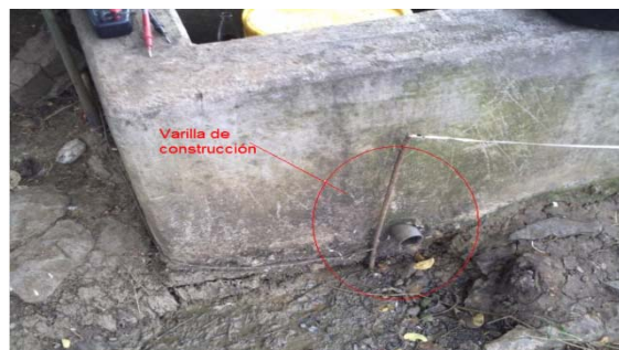
Figura Revisión 13: Puestas a Tierra Fuente: Autores
