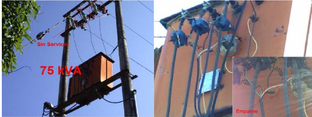
Figura Revisión 2: Transformador Fuente: Autores
