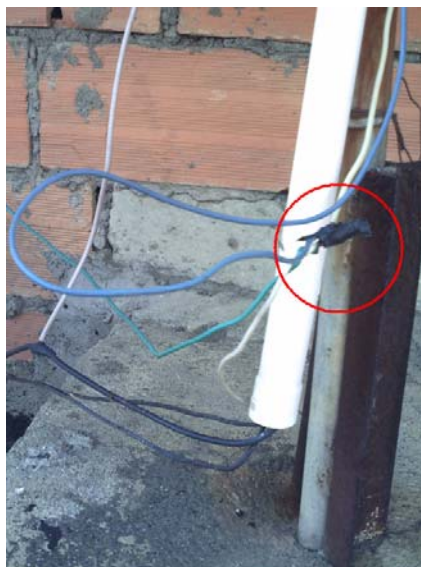
Figura 32. Empalme mal hechos Fuente: Autores
