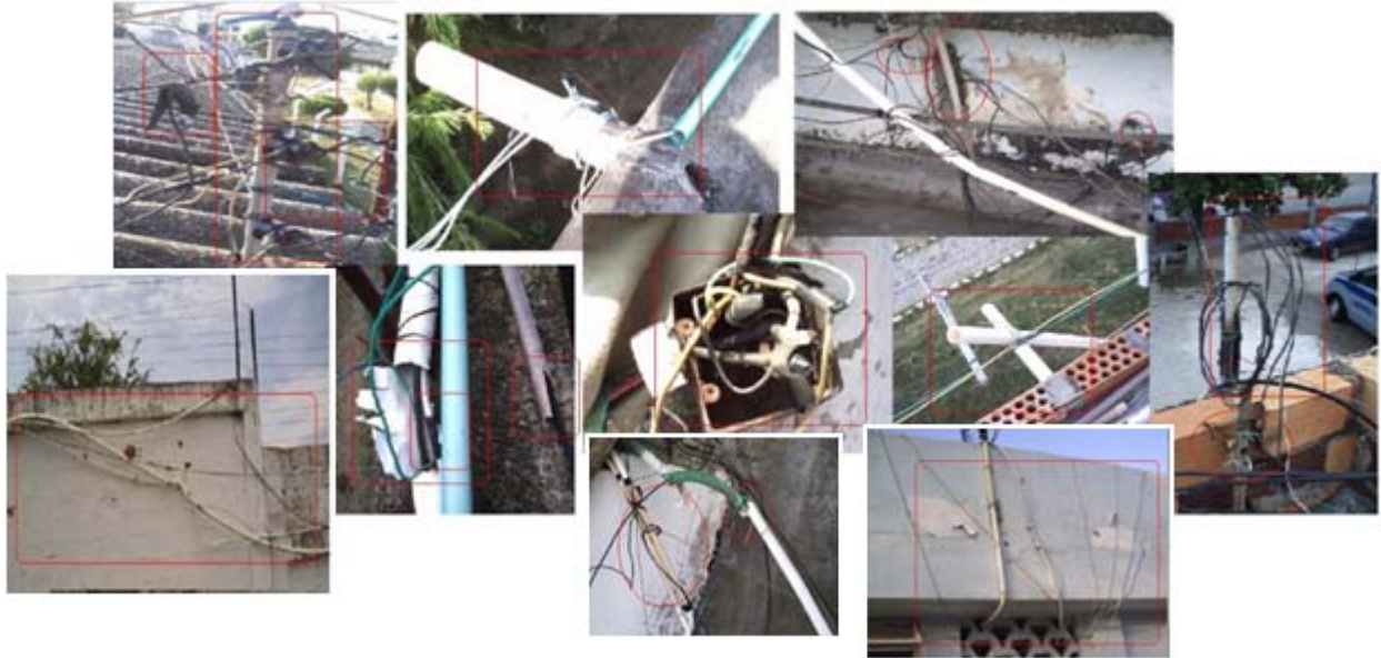
Figura Revisión 5: Acometidas Aéreas. Fuente: Autores
