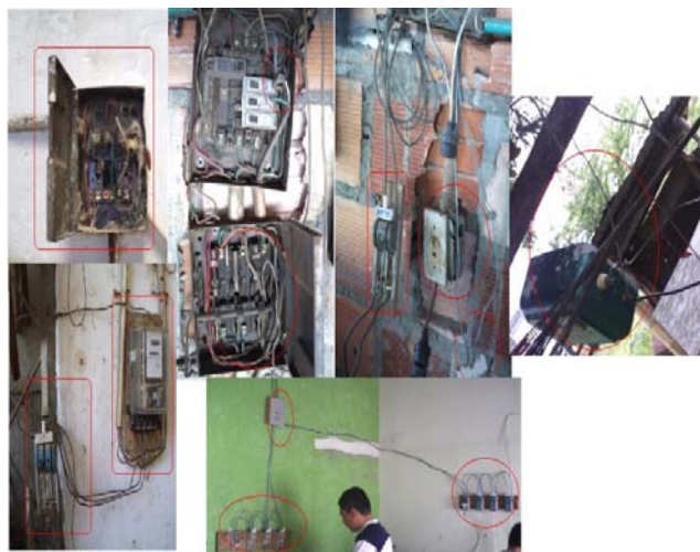
Figura Revisión 9: Protecciones Fuente: Autores
