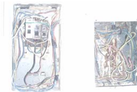
Figura 24. Tablero Patio 2 - TPA Fuente: Autores
