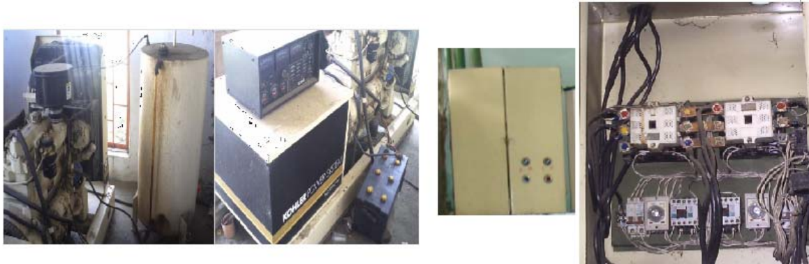
Figura Revisión 14: Planta Eléctrica Fuente: Autores
