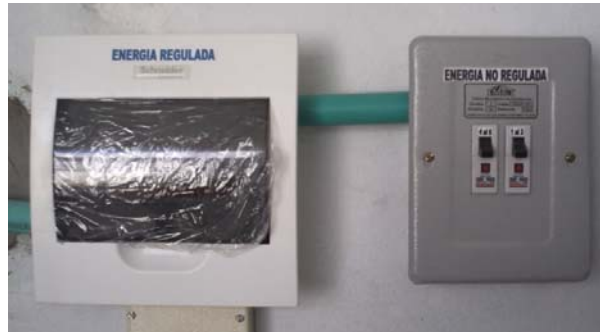
Figura 17. Tablero aulas de computo - TAC-R y TAC-NR Fuente: Autores
