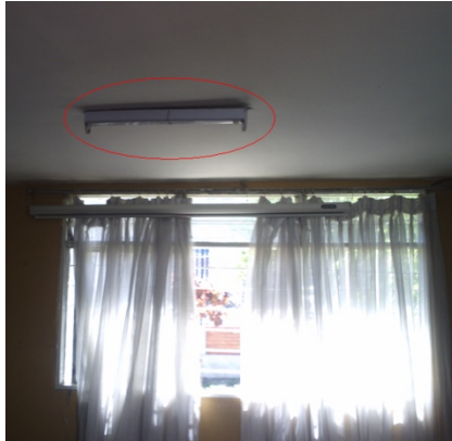
Figura 29. Luminaria sin fuente de luz Fuente: Autores
