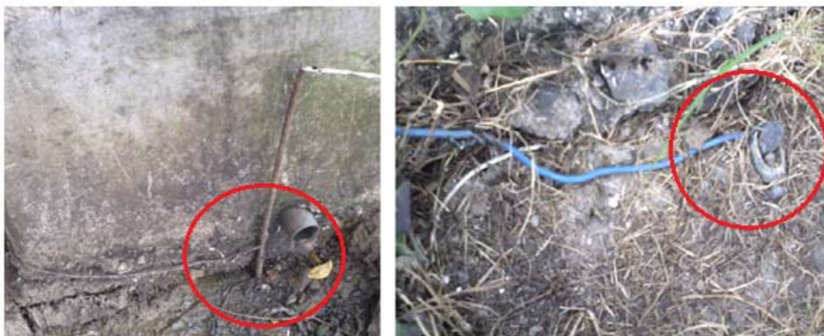
Figura 4. Puesta a tierra granja externa y antena de comunicación Fuente: Autores
