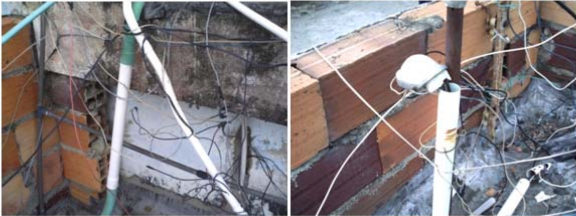
Figura 33. Salida de acometidas aéreas del tablero general TG Fuente: Autores
