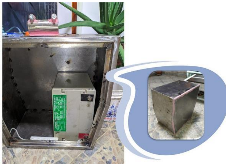
Figura 33. Unidad estructural de potencia con tapa trasera y batería VRLA.
