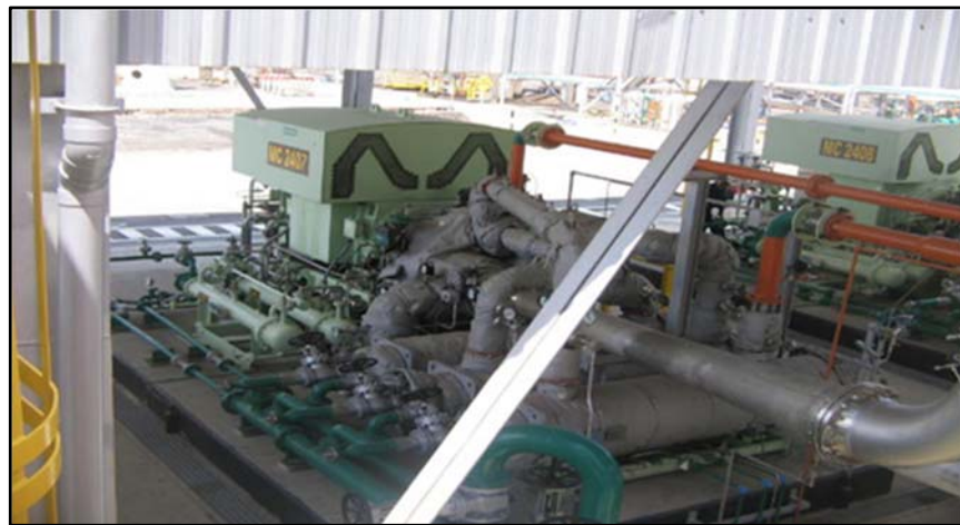
Figura 7. Compresores Sistema aire de instrumentos C2407 y C2408.
