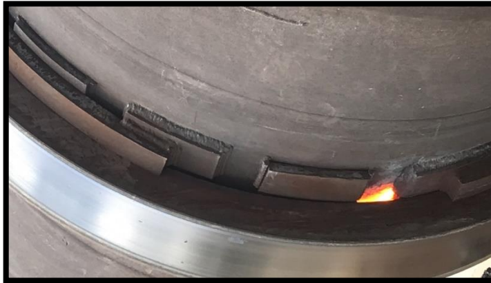
Figura 7. Daño chapa horno.
