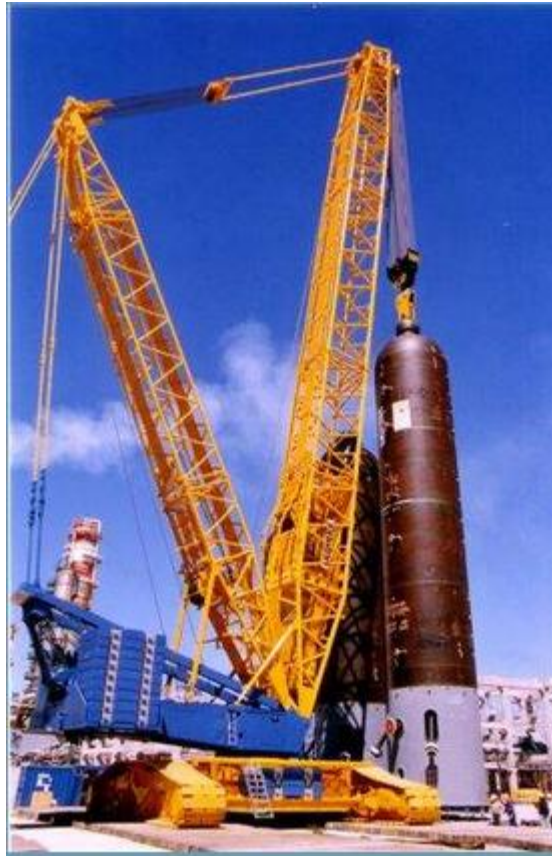
Figura 7. Grúa pluma lateral
