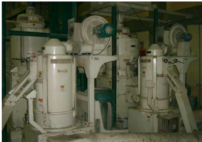
Figura 17. Pulidores VTA y VBF dos líneas
