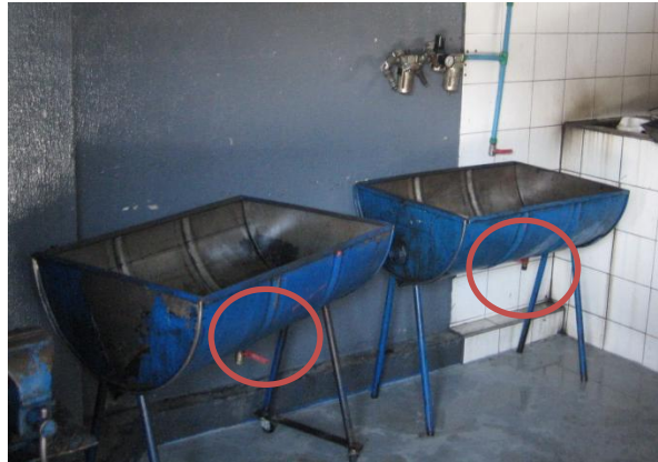
Foto 25. Válvulas de desagüe cuarto de lavado
