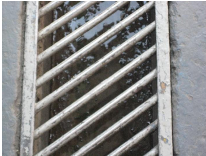
Foto 9. Rejilla para aguas lluvias taller 1 Mayorautos S.A.
