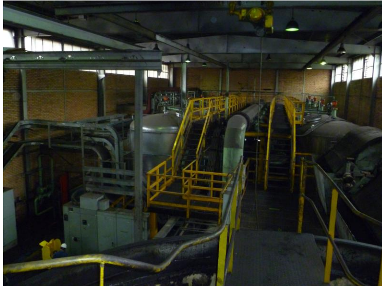
Figura 4. Sala de filtros PTA
