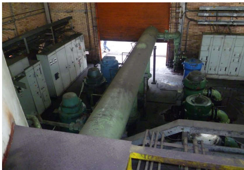
Figura 5. Sala de bombas, PTA
