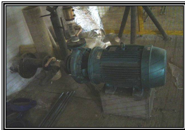
Figura 44. Bombas instaladas para el Sótano del Edificio de Ciencias Humanas.
