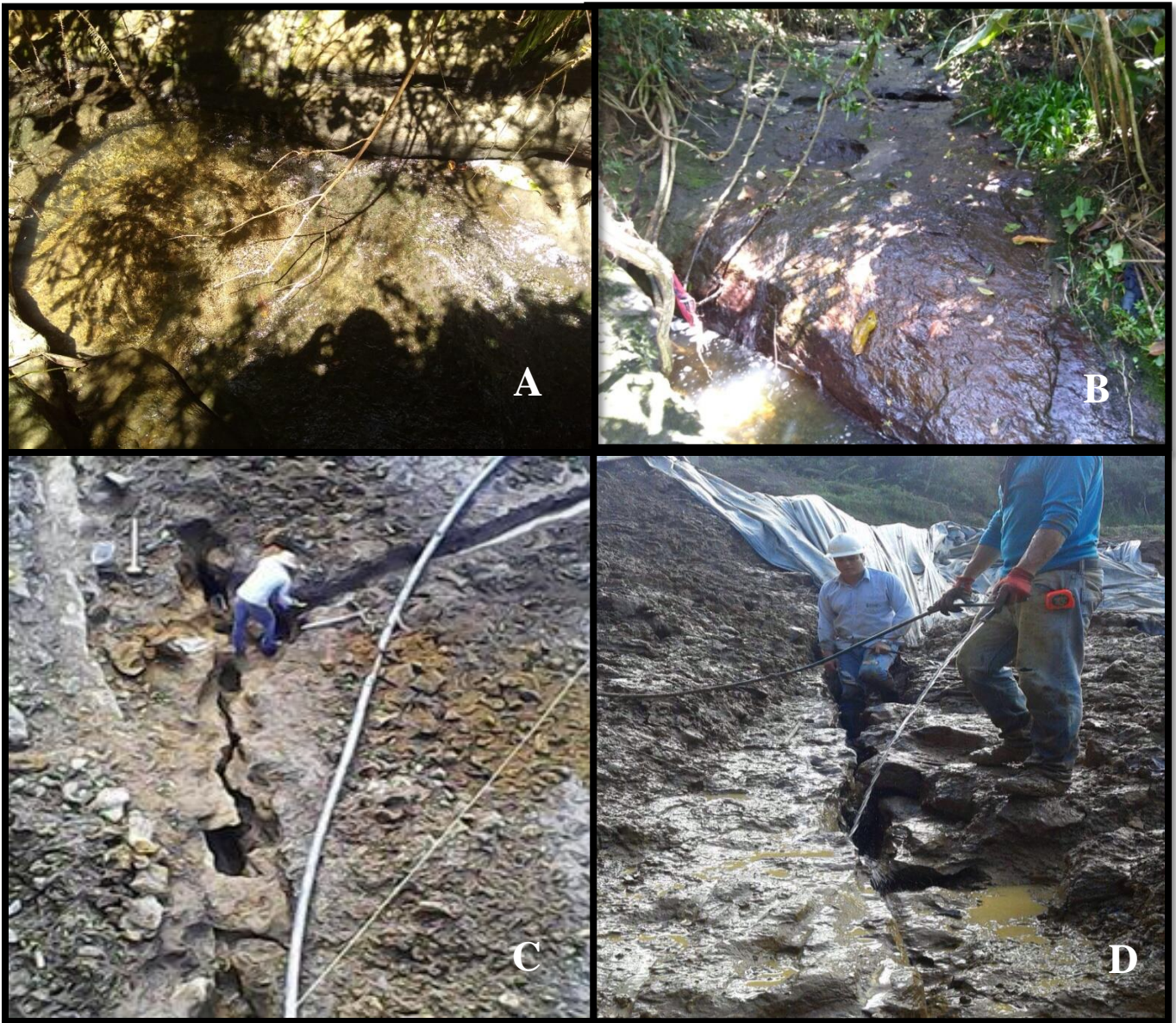
Figura 43. Evidencias de karstificación; A y B: Disolución en forma concéntrica sobre quebradas adyacentes, esto puede corresponder al principio de formación de dolinas; C y D: Fracturas sobre el vaso de la presa ensanchadas producto de la karstificación.
