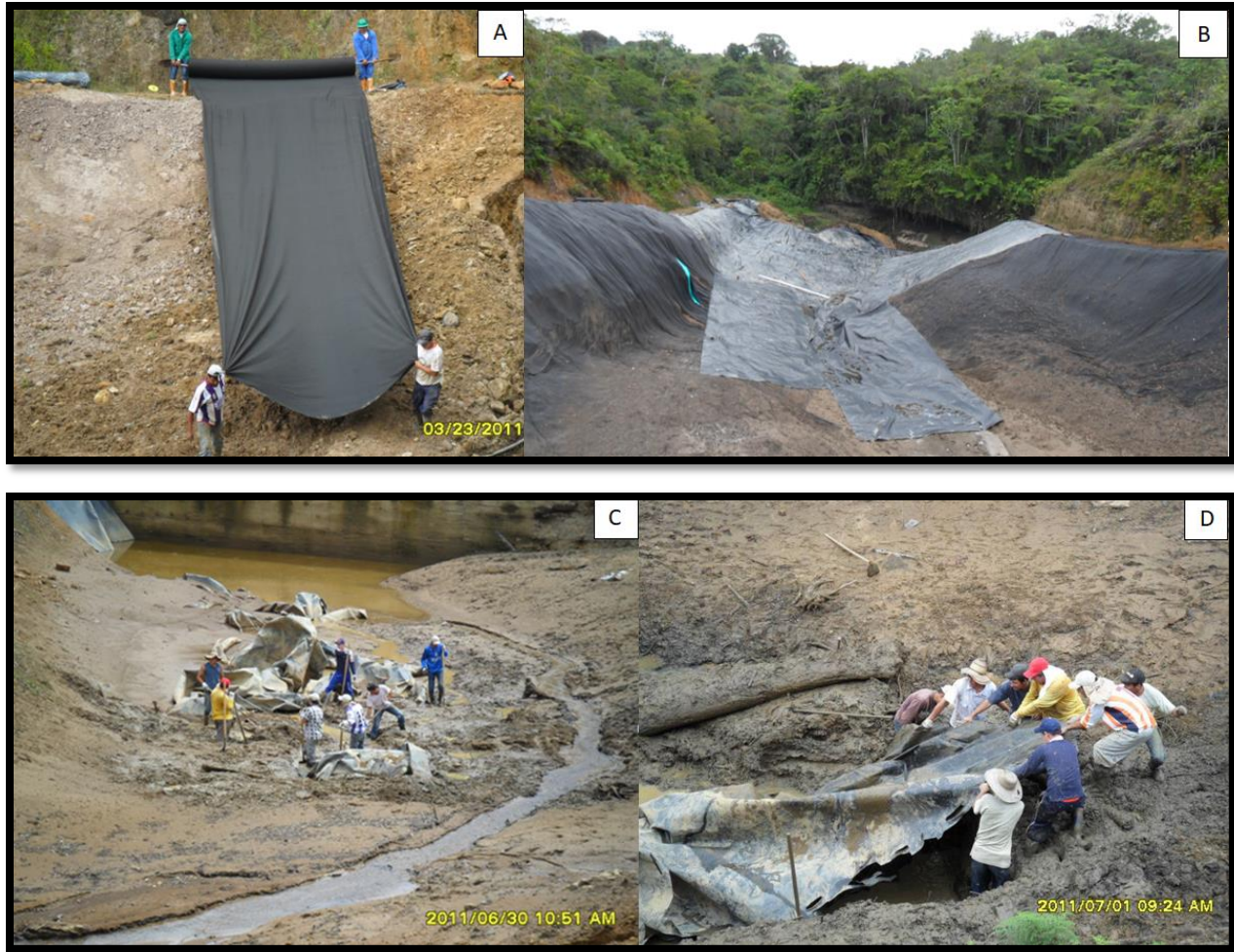
Figura 7. Estado de la presa año 2011. (A) inicios de la colocación de la Geo membrana y geotextil sobre el vaso de la presa; (B) finalización del proceso de impermeabilización sobre el vaso; (C) y (D) resultados tras el incidente en el cual la corriente arrastró con la geo membrana instalada sobre el vaso de la presa para posible impermeabilización. Fuente: Imágenes tomadas y modificadas de la recopilación fotográfica Contrato No. 1302- 10 Impermeabilización Leona.
