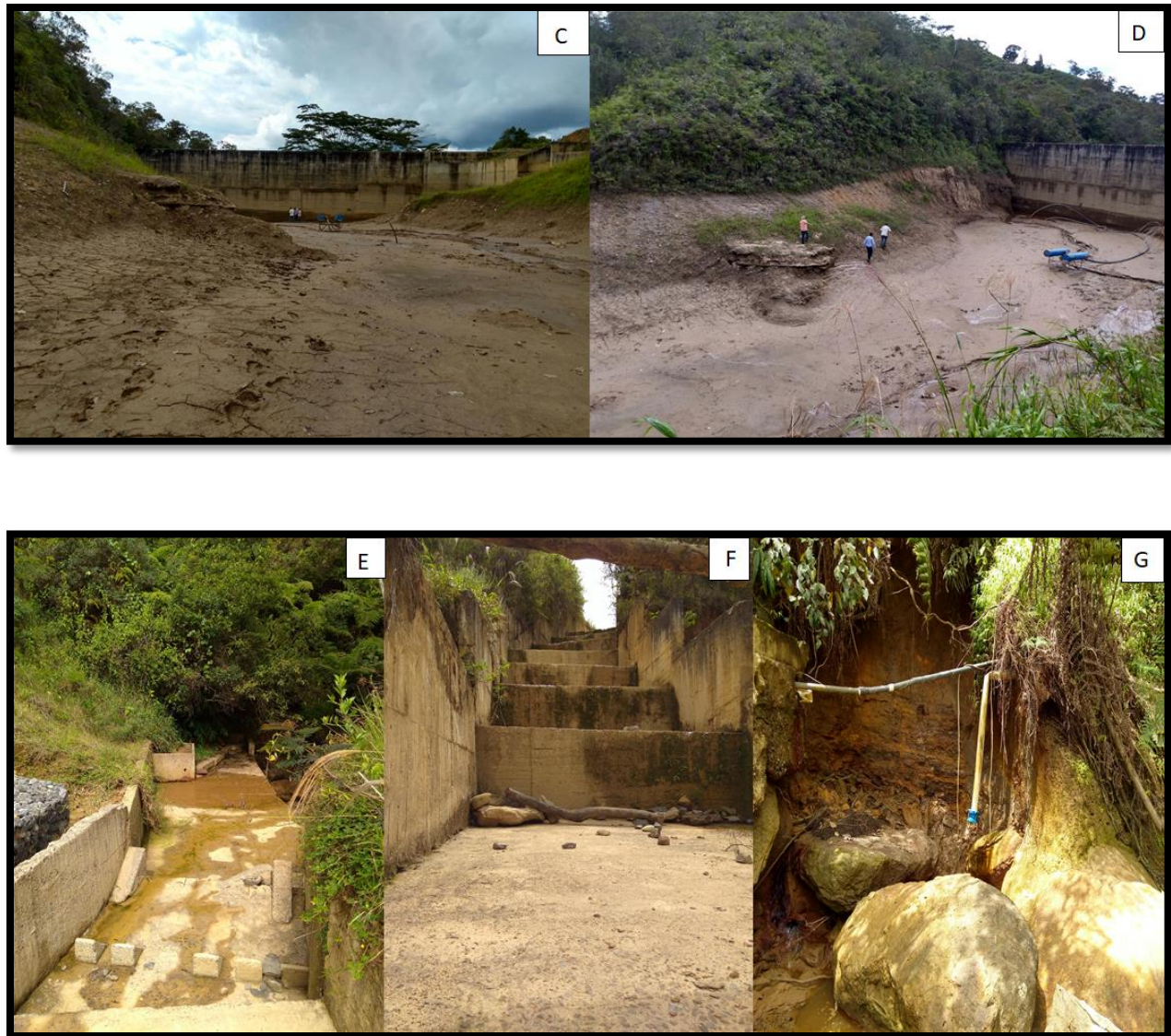
Figura 11. Estado de la presa año 2017-2018 ; A) terraplén de soporte; (B) vaso colmatado de sedimento; (C) y (D) vista del vaso aguas arriba del muro de presa; (E) y (F) estado actual canal de excesos; (G) estado actual tubería aguas abajo del muro de presa.
