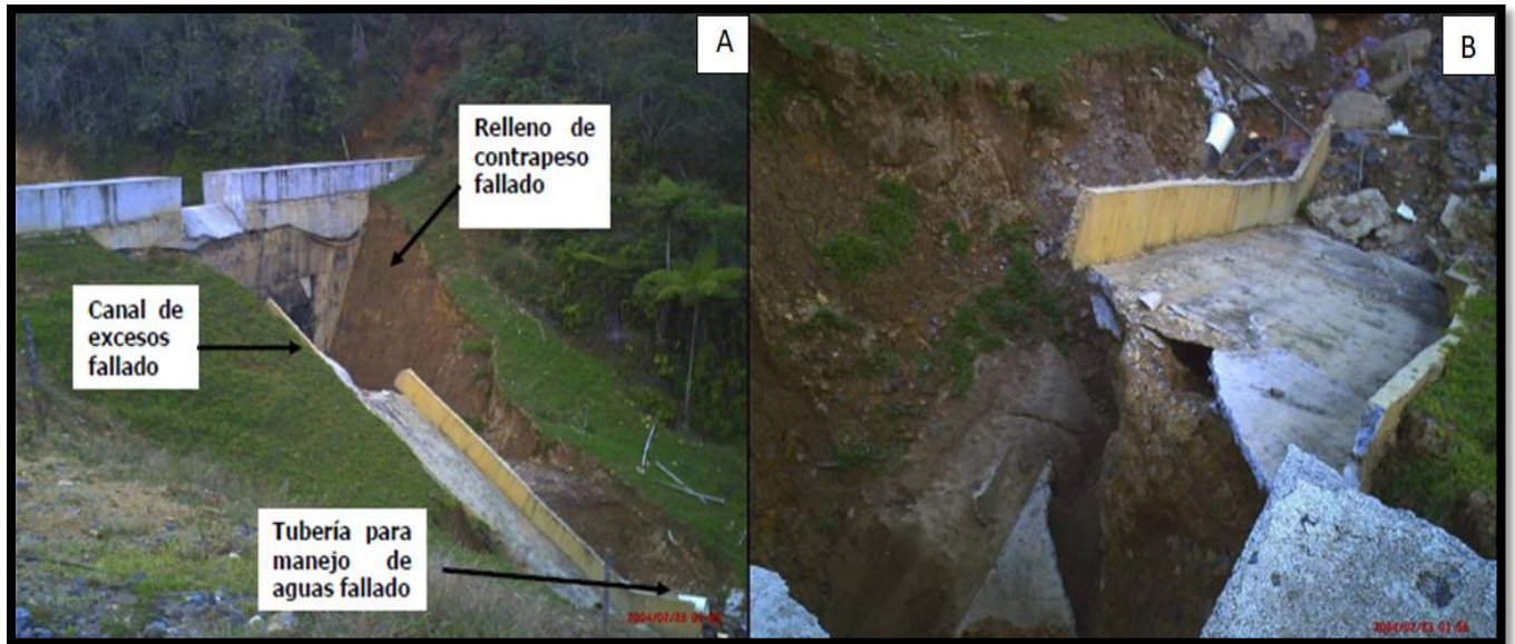
Figura 5. Estado de la presa año 2007-2008: (A) y (B) canal de excesos, relleno de terraplén y tubería para el manejo de aguas colapsada. Fuente: Imágenes tomadas y modificadas de la recopilación fotográfica Contrato No. 1914-07 Presa Suaita.
