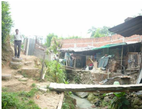
Puente que comunica el abismo con las viviendas, elaborado con tablas en mal estado.
