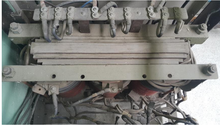
Figura 1. Estado inicial de las conexiones de entrada
