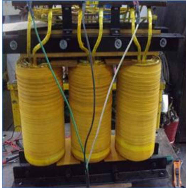
Figura 6. Transformador conectado para pruebas
