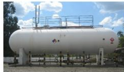
C) Tanque de almacenamiento horizontal.
