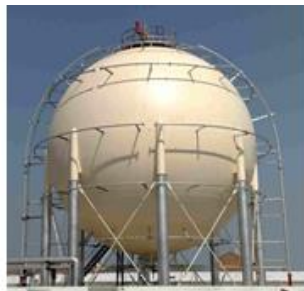
B) Tanque de almacenamiento esférico.
