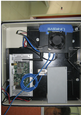
(a) Caja de comunicaciones, módem y routers
