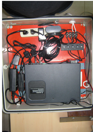
(b) Caja del analizador de redes eléctricas y acometidas.
