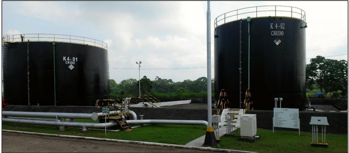
Figura 15. Tanques de almacenamiento.
