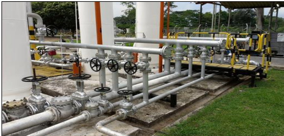
Figura 5. Manifold de entrada.
