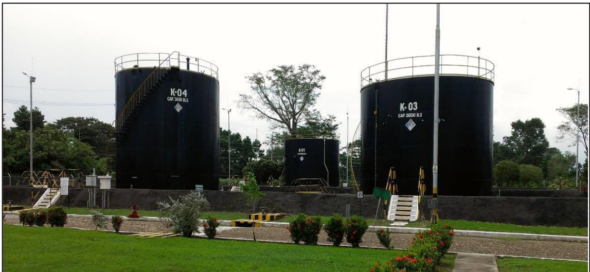
Figura 8. Tanques de almacenamiento.
