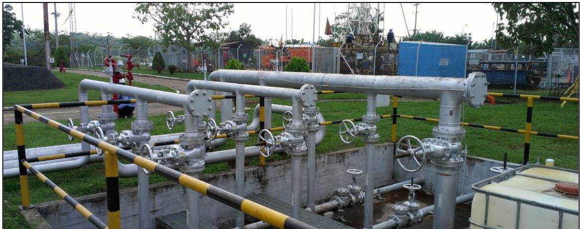
Figura 12. Manifold de entrada.
