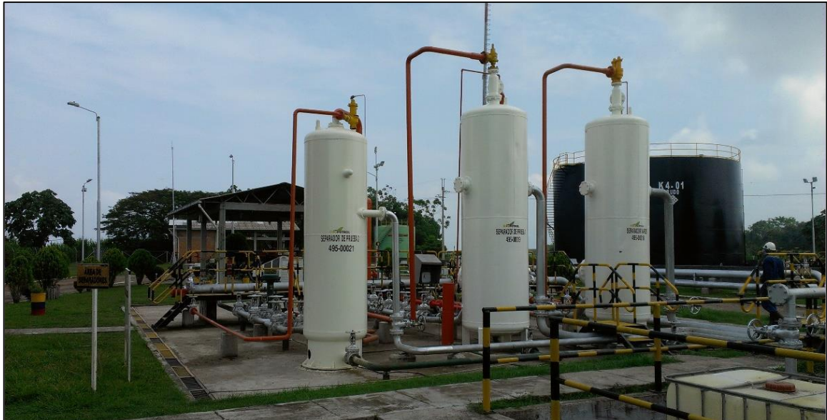
Figura 13. Área de separadores.
