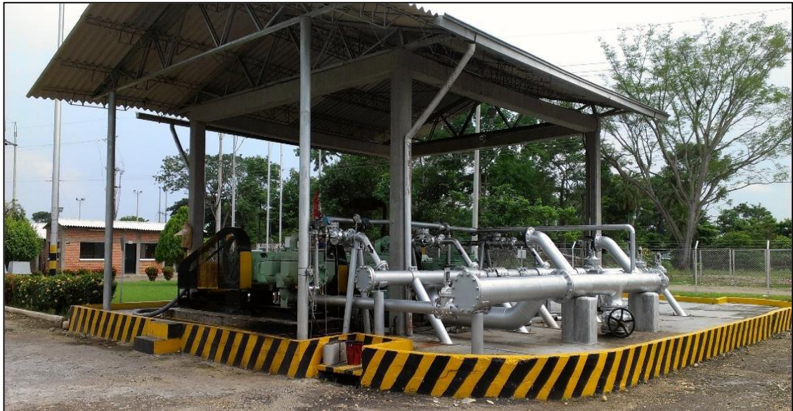
Figura 9. Bombas de despacho.
