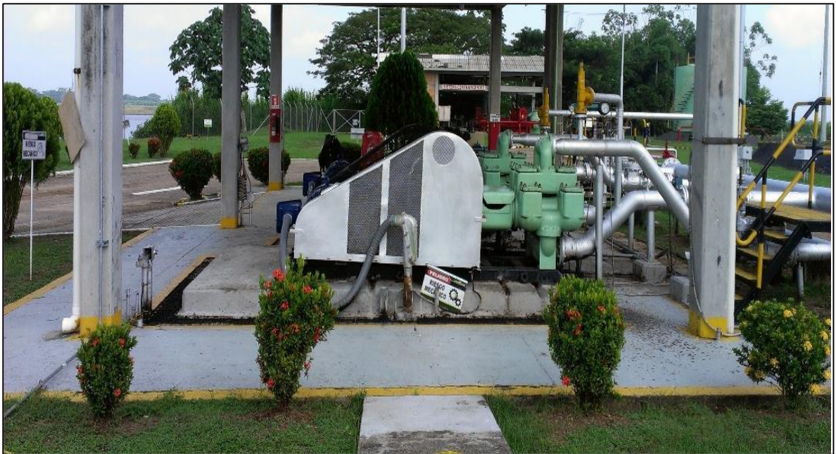
Figura 16. Bombas de despacho.
