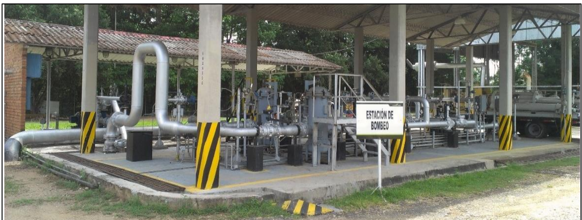
Figura 23. Estación de bombeo.
