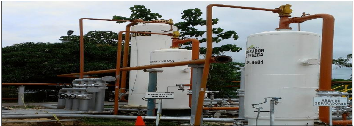
Figura 19. Área de separadores.
