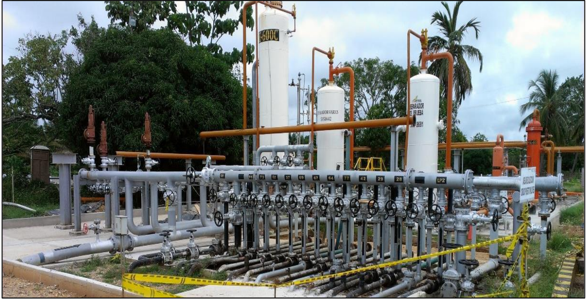
Figura 18. Manifold de entrada.
