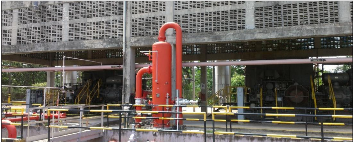
Figura 22. Planta compresora de gas Yariguí.
