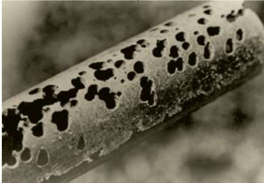
Figura 20. Tubería corroída debido a la presencia de bacterias.
