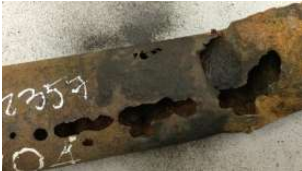
Figura 17. Corrosión Uniforme en tuberías
