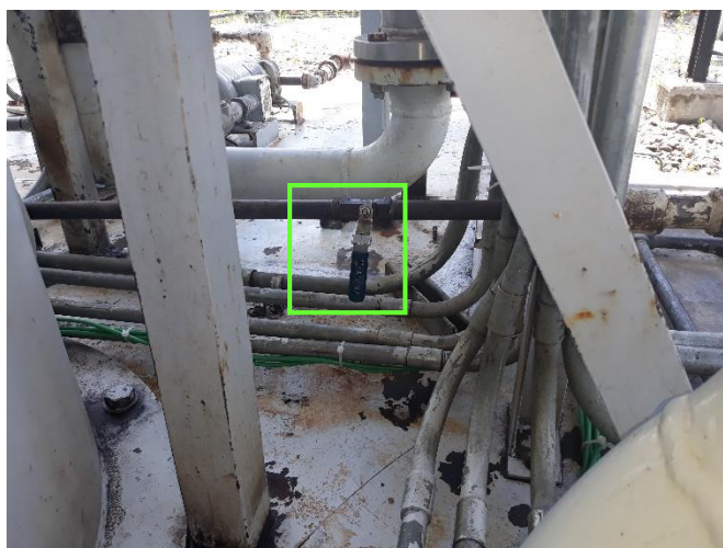
Figura 27. Ubicación para reemplazar por válvula controladora VRU-EISA.
