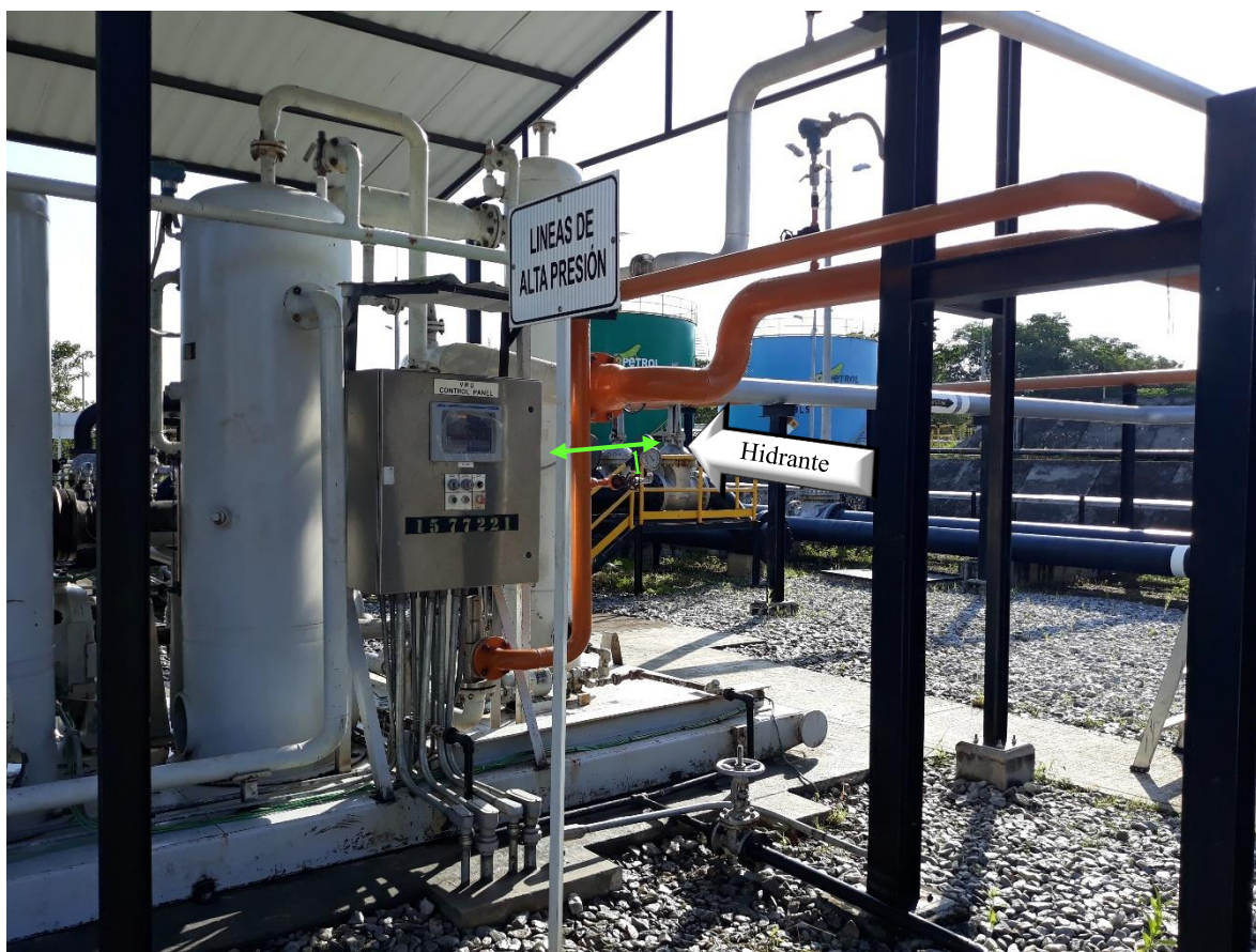
Figura 20. Ubicación de Hidrante manual VRU-EISA.
