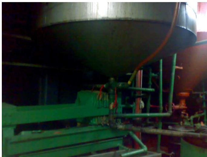
Figura5.Tanque 5 y filtro prensa
