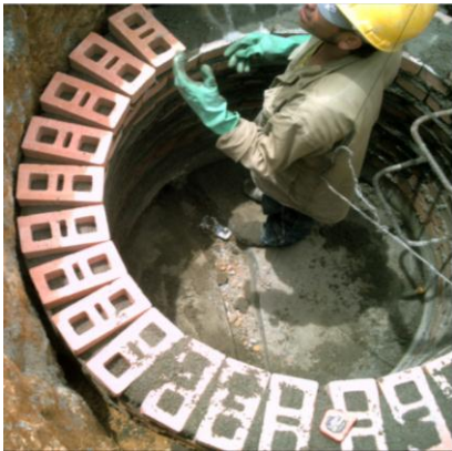
Figura 17. Pozo de inspeccion con ladrillo Fuente: el autor.
