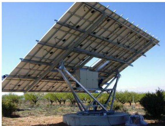
Figura 137 Plantas fotovoltaicas con seguidores
