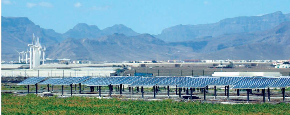
Figura 135 Central Solar Fotovoltaica
