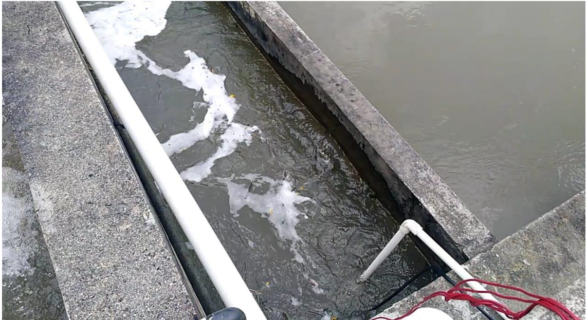
Figura 101. Moto bomba succionando agua coagulada, justo antes de la entrada a los floculadores actuales (sistema de eje rotatorio horizontal).
