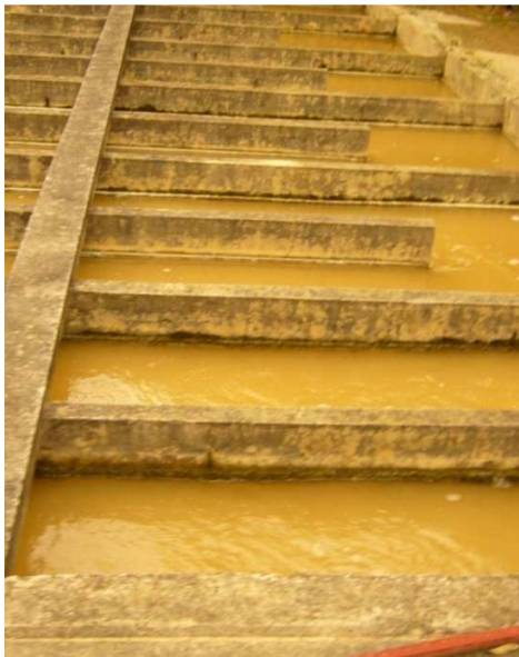
Fotografía 10 Floculadores Hidráulicos Horizontales.
