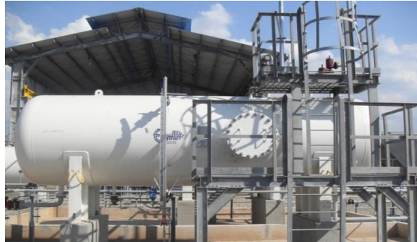
Figura 16. Tanque de condensados.
