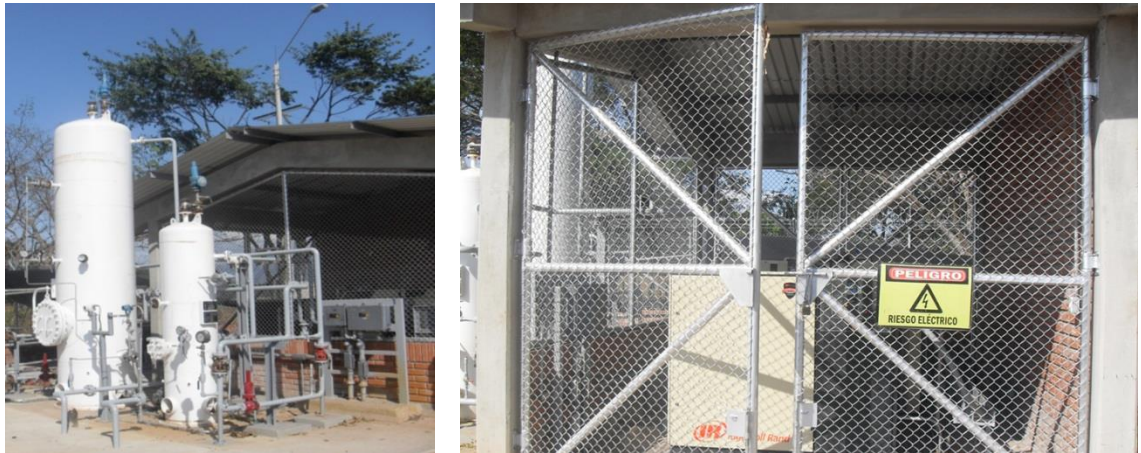
Figura 18. Sistema de aire comprimido
