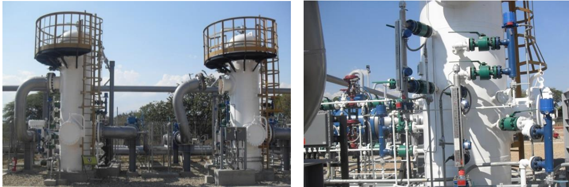
Figura 10. Sistema de filtración en la descarga y medición de gas.
