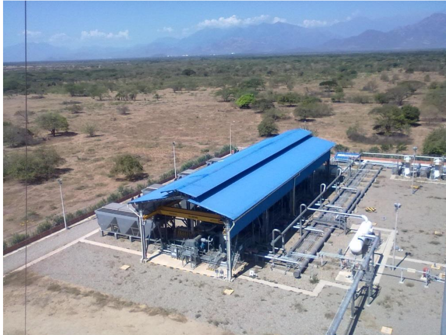
Figura 2. Estación de compresión de gas Jagua del Pilar.
