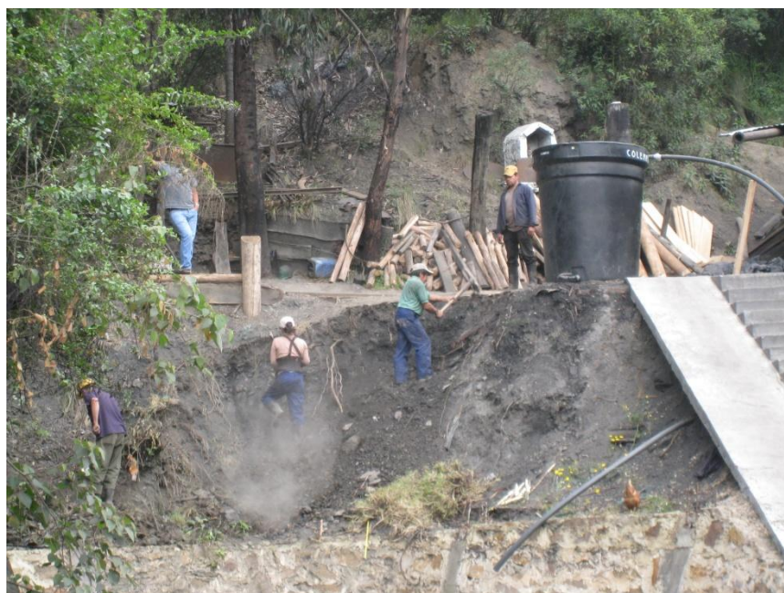
Foto 31. Perfilado de taludes en forma manual, sin ninguna planeación para planes de reforestación.
