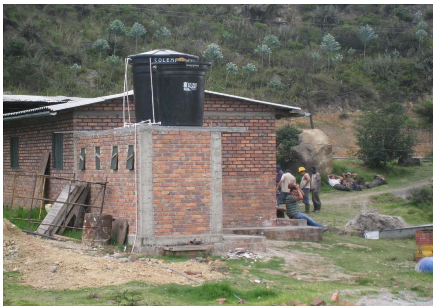
Foto 53. Construcción de unidades sanitarias de campamentos sin un adecuado sistema de tratamiento de aguas residuales.
