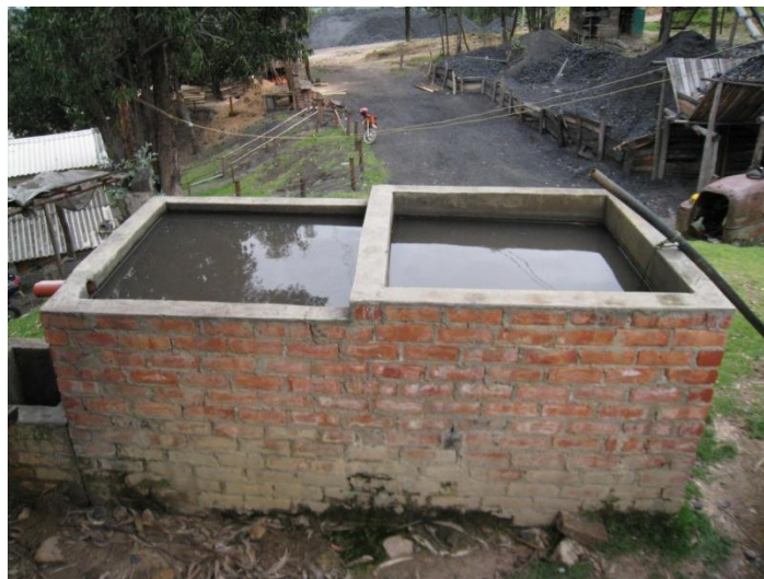
Foto 15. Modelo de tanque sedimentador y estabilización de pH.
