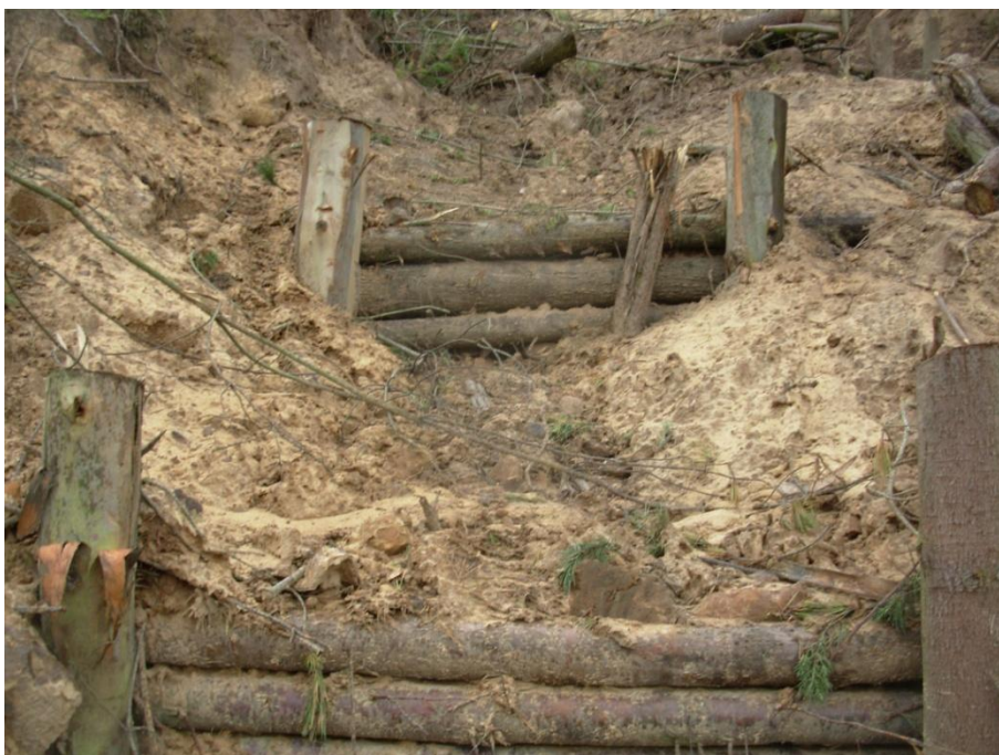
Foto 45. Trincho en madera en área erosionada en una cárcava.
