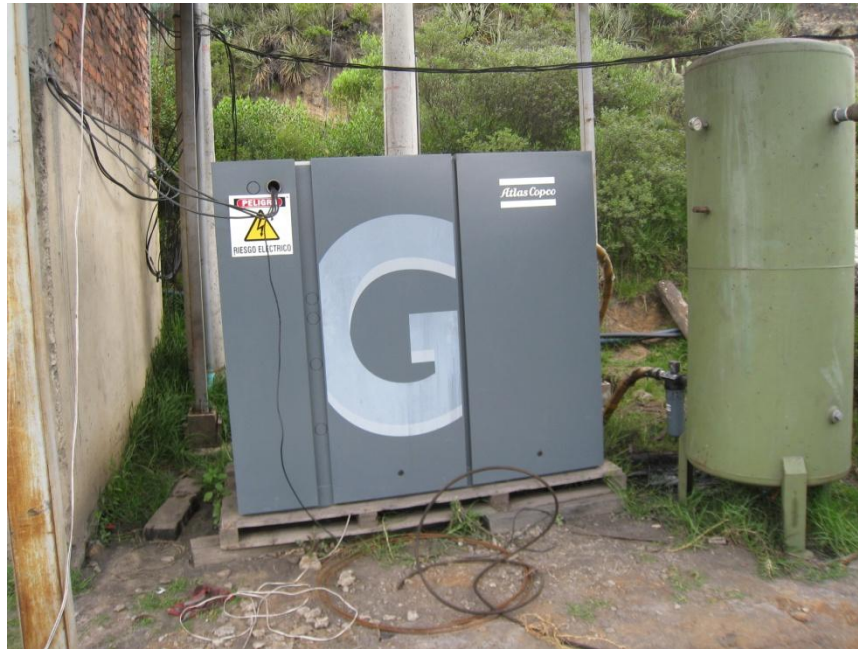
Foto 59. Sistema de compresores eléctrico sin una infraestructura para su protección.
