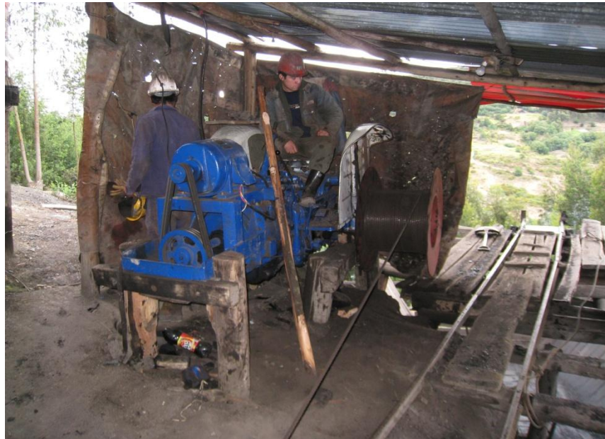
Foto 63. Malacate tipo de diesel instalado en deficientes condiciones de seguridad industrial.
