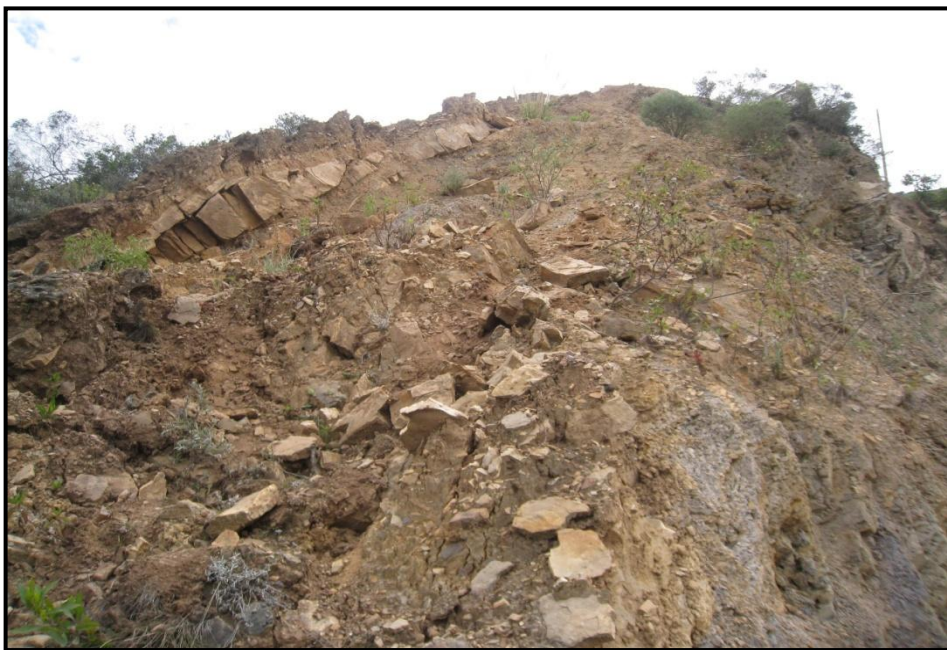
Foto 18. Desestabilización de macizos rocosos con inminente caída de detritos.
