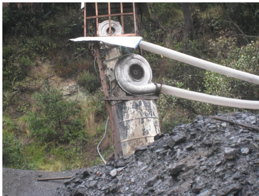
Foto 8. Sistema de ventilación eléctrico inadecuado para manejo de gases en el interior de la explotación.
