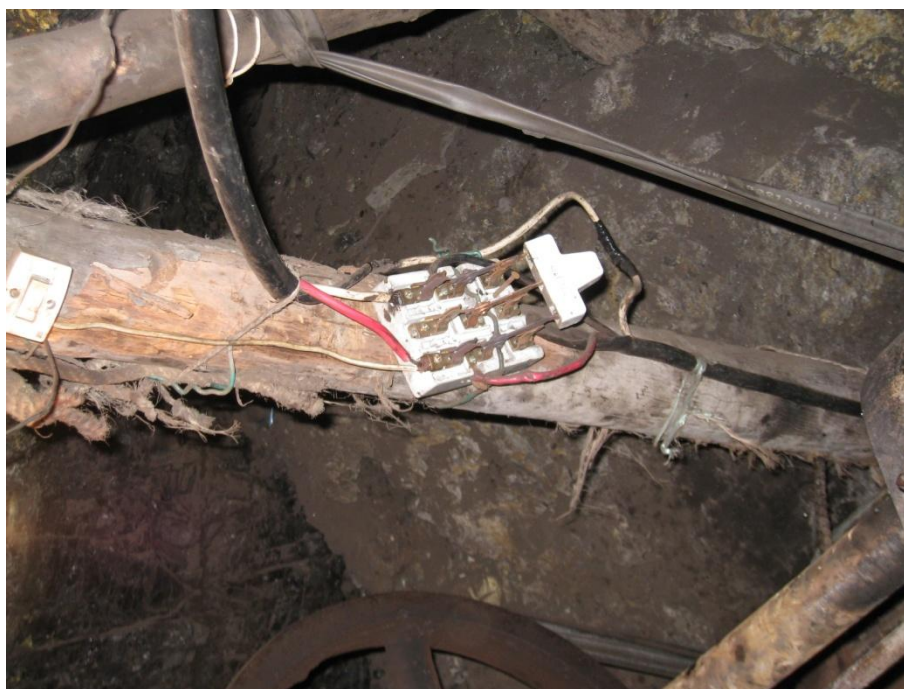
Foto 58. Deficiente instalaciones eléctricas al interior de la mina.
