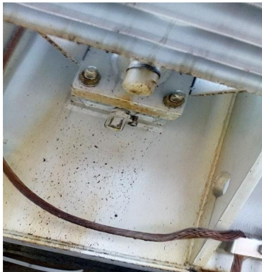
Figura 8 Fuga de aceite en transformador de distribución.
