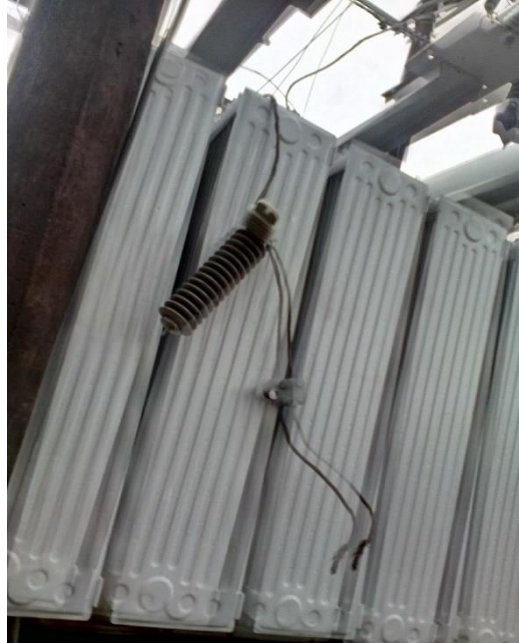
Figura 9. Pararrayo tipo línea explotado en subestación de distribución.
