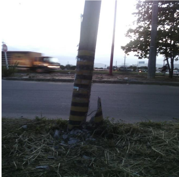
Figura 7. Poste de media tensión cercano a la vía, fracturado por colisión con vehículo automotor
