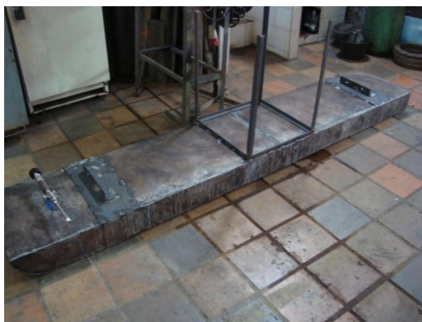
Figura 34. Flotador estructura soporte bomba
